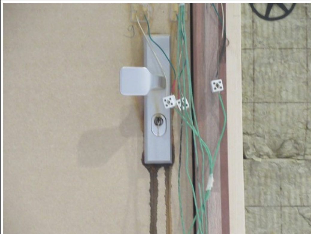
Foto 5: Beproeving na 7 minuten, rook uit slot deur A
